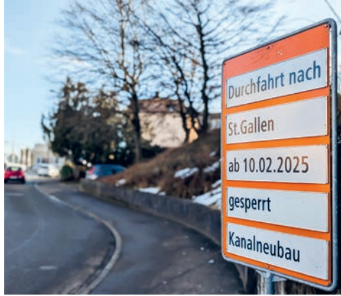
Bauarbeiten in St.Gallen verhindern die Durchfahrt der Bruggwaldstrasse während rund eines halben Jahres.
